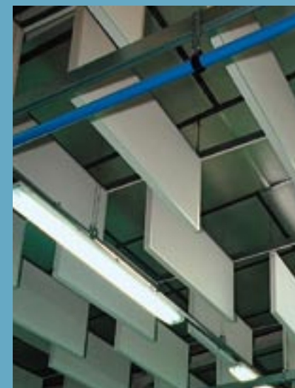
Capteurs de sons dans les salles techniques.
