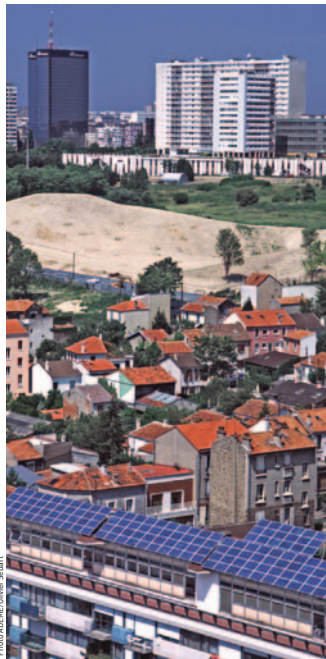
Production d'électricité par des capteurs installés en toiture dans les immeubles de l'OPHLM de Montreuil. 220m 2 de panneaux de photovoltaïque installés sur le toit d'un immeuble HLM.
