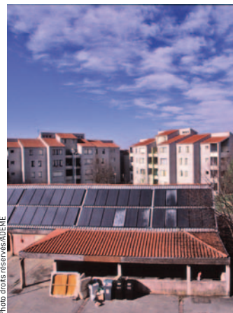
Modules solaires thermiques destinés à l'alimentation en eau chaude solaire des H.L.M. de la banlieue de Toulouse.
